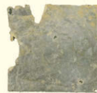
耐候劣化、加水分解
